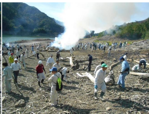
流木搬出作業状況
